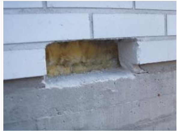
Kuva 54. B-osalla julkisivumuurauksen ja lämmöneristeen välissä on työvara, mutta laastipurseet ovat kiinni lämmöneristeissä.
