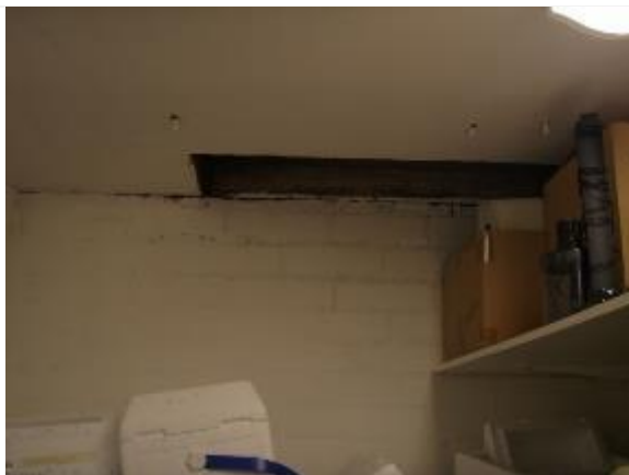
Kuva 18. A-osan perusmuurin rakenne on korjaamatta varaston A005 kohdalla.
