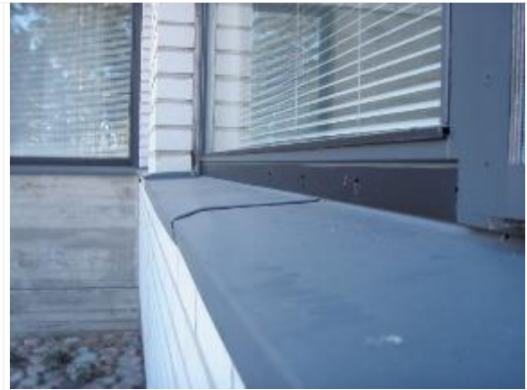
Kuva 68. B-osalla ikkunapeltien kallistus on loiva.
