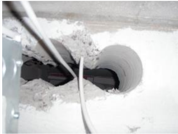
Kuva 43. Tiivistämätön väliseinän läpivienti.
