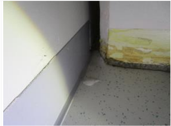
Kuva 35. Pilarin ja väliseinän rakoa ei ole tiivistetty.
