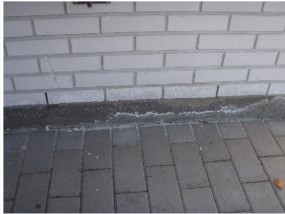
Kuva 57. C-osalla julkisivumuurauksen alaosassa ja sokkelibetonissa esiintyy kosteusjälkiä.
