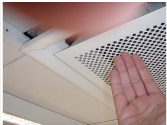
Kuva 46. Tuloilman jäähdytyspalkin pinnoilla rakennusaikaista pölyä, toimisto A105.
