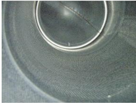
Kuva 92. Puhdas tuloilmakanava A-osa, TK07.
