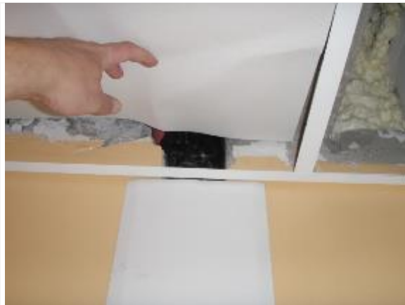
Kuva 42. Sama vanha ulkoseinä 1. krs käytävällä A135 on alakaton yläpuolella avoin.
