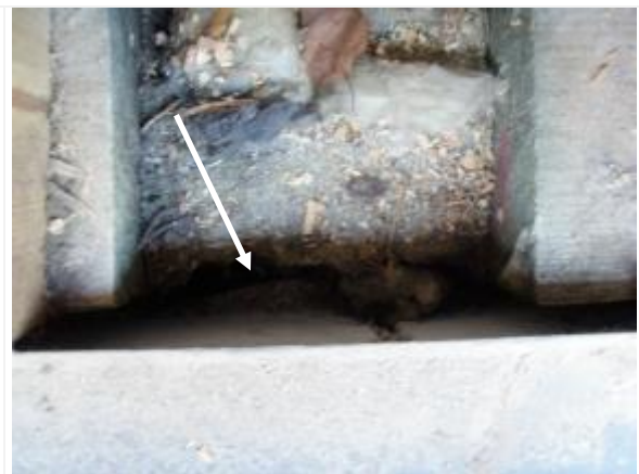
Kuva 56. C-osalla julkisivumuurauksen ja lämmöneristeen välissä on tuuletusrako, mutta laastipurseet ovat kiinni lämmöneristeissä.
