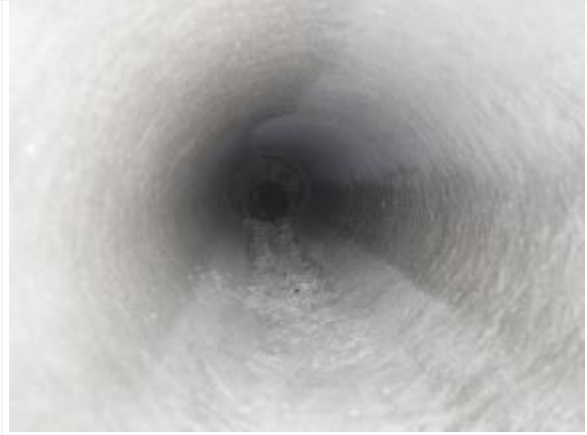
Kuva 96. Betonisen tuloilmakanavan pohjalla on erittäin runsaasti hienojakoista betonipölyä, tila C147.
