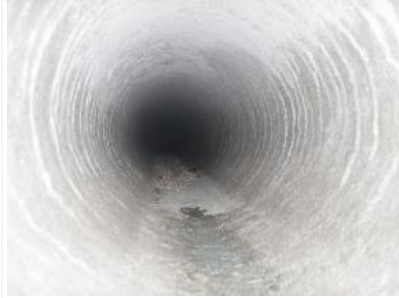
Kuva 95. Betonisen tuloilmakanavan pohjalla on erittäin runsaasti hienojakoista betonipölyä, tila C113.
