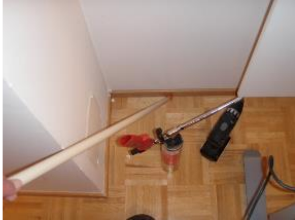
Kuva 85. Putkiläpiviennistä tuleva kaasu kulkeutuu parketin alla väliseinän liittymään.
