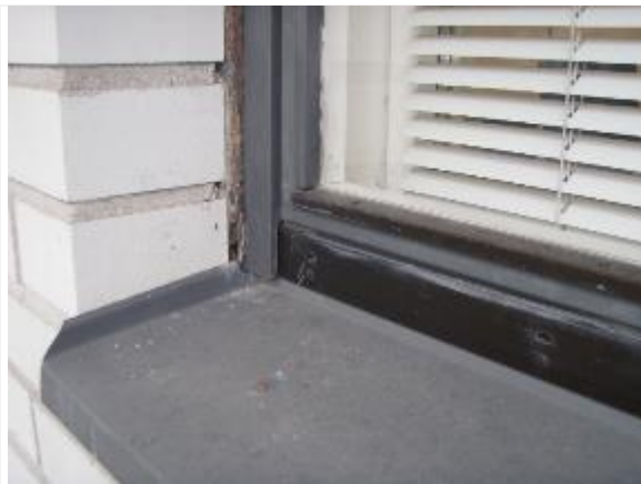
Kuva 69. Ikkunapeltien päitä ei ole tiivistetty julkisivumuuraukseen, ikkunan ja julkisivumuurauksen saumaus on huonokuntoinen B-osa.
