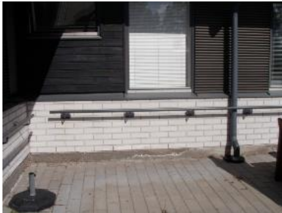
Kuva 14. C-osan sokkelissa maaperän kosteuden aiheuttamaa härmettä.
