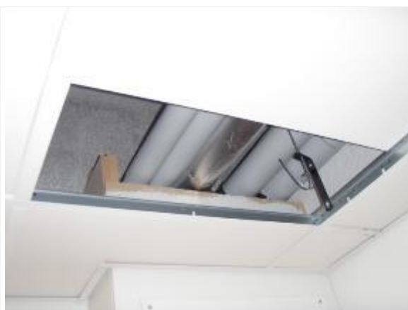
Kuva 38. Tiivistys katkeaa tuloilmanpäätelaitteeseen.
