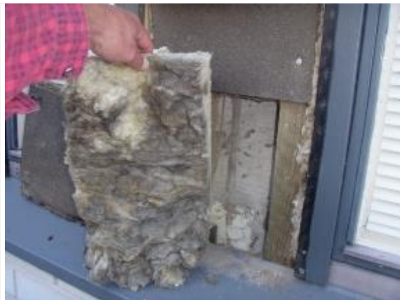
Kuva 66. C-osan ikkunanauhan väliosien lämmöneristeet on tummuneet ilmavirtauksen takia.
