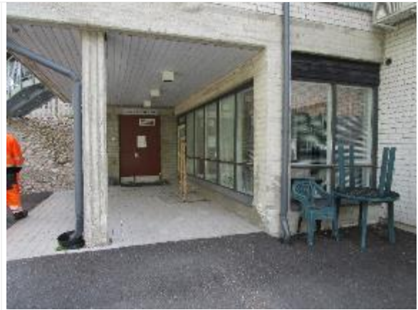
Kuva 58. C-osan neuvotteluhuoneen C012 kohdalla sokkelibetonissa esiintyy kosteutta.
