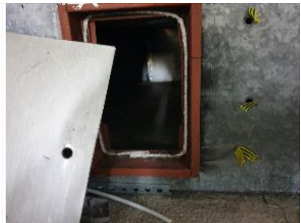
Kuva 94. Keittiön tuloilmakoneen TK1 runkokanavan tarkastusluukku on tiivistetty asbestinarulla.
