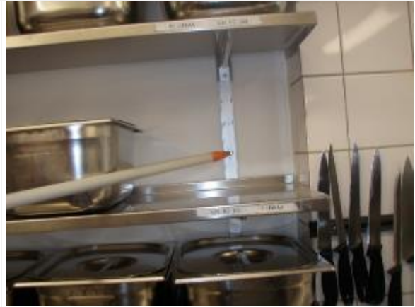
Kuva 82. Tyypillinen vuotokohta laskettaessa merkkiaine ulkoseinärakenteen eristetilaan, lounaispääty kevytrakenteinen ulkoseinä, keittiö.
