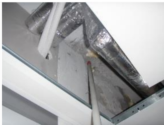
Kuva 90. Keittiön sisäilmasta on ilmayhteys toimiston A128 sisäilmaan tekniikkakuilun kautta.
