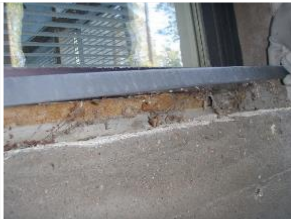
Kuva 59. Neuvotteluhuoneen C012 ikkunan apukarmipuu on kiinni kosteassa sokkelibetonissa.
