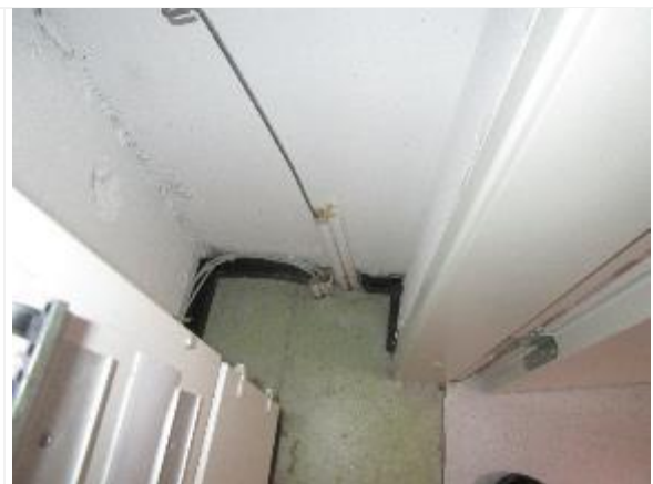
Kuva 104. Ryhmä- ja jakokeskuksissa on avoimia läpivientejä.
