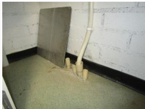
Kuva 103. Ryhmä- ja jakokeskuksissa on avoimia läpivientejä.
