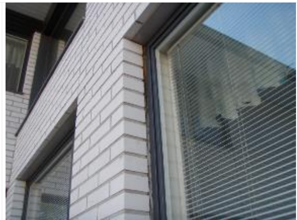
Kuva 70. Ikkunan ja julkisivumuurauksen saumaus on huonokuntoinen ja epätiivis B-osa.
