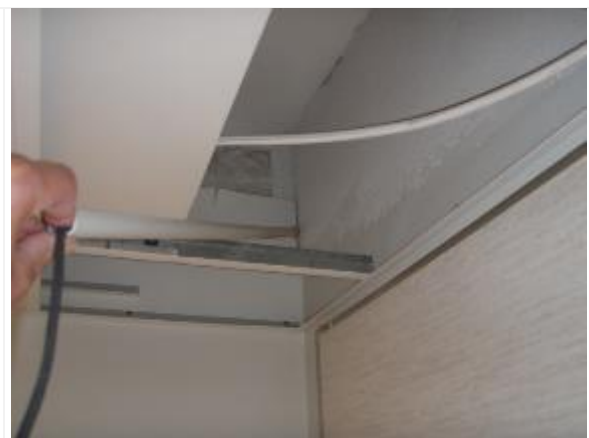
Kuva 91. Keittiön sisäilmasta on ilmayhteys toimiston A128 sisäilmaan tekniikkakuilun kautta.
