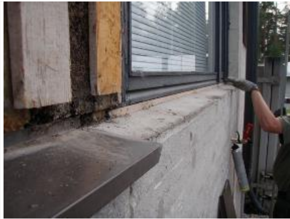
Kuva 67. A-osalla ikkunapeltien kallistus on loiva.
