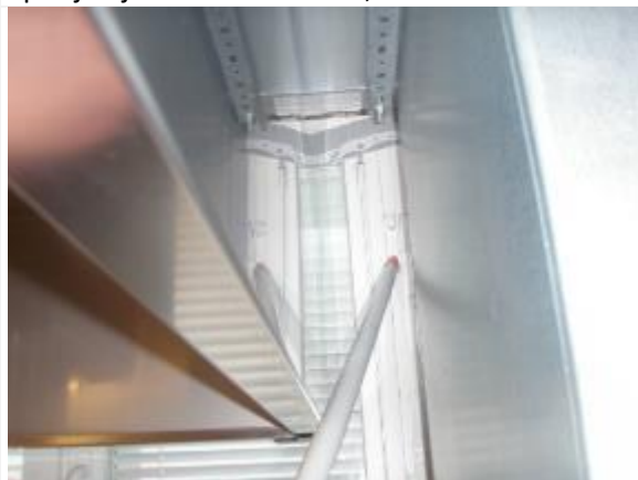
Kuva 79. Tyypillinen vuotokohta laskettaessa merkkiaine ulkoseinärakenteen eristetilaan, ikkunan ja ulkoseinän liitos, keittiö koillispäätä.
