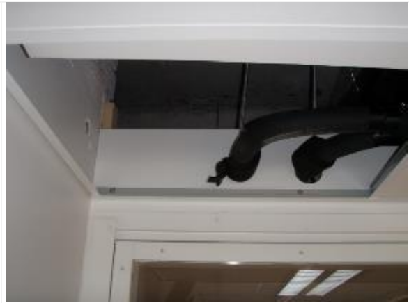
Kuva 44. Toimiston B105 väliseinä on alakaton yläpuolelta avoin.
