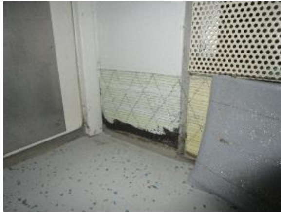
Kuva 34. Tiivistys katkeaa tuloilmanpäätelaitteeseen.
