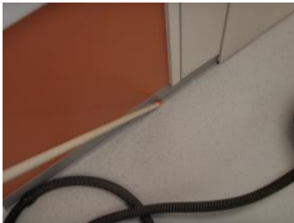
Kuva 87. Väliseinä vuotaa tiivistettyjen huoneiden kohdalla käytävän puolelle. Toimiston puolella vuotoa ei havaittu.
