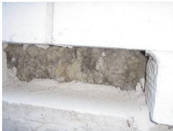
Kuva 55. C-osalla julkisivumuurauksen ja sokkelibetonin välissä ei ole kapillaarikatko.
