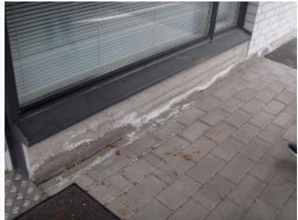
Kuva 15. C-osan sokkelissa maaperän kosteuden aiheuttamaa härmettä.
