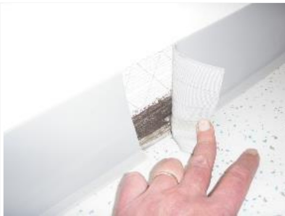
Kuva 36. Tiivistys katkeaa tuloilmanpäätelaitteeseen.
