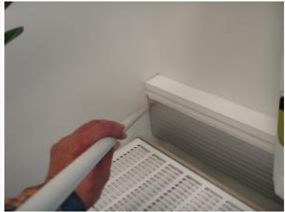
Kuva 76. Tyypillinen vuotokohta laskettaessa merkkiaine ulkoseinärakenteen eristetilaan, ulkoseinän sähkökouru, B-osa 1krs.
