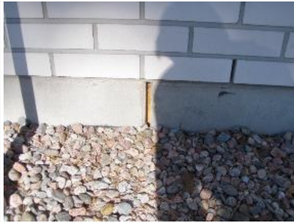
Kuva 105. Uuden A-osan sokkelipalkin saumat ovat saumaamatta.
