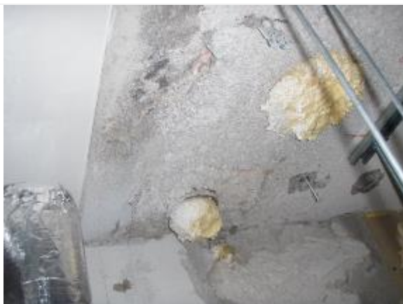
Kuva 73. Epätiivittä läpivientejä yläpohjarakenteen läpi A-osalla.
