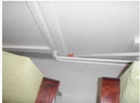
Kuva 84. Ryhmäliikuntatilan C008a ulkoseinään laskettu merkkiaine kulkeutui neuvotteluhuoneen C012 puolelle patteriputkien, seinän liikuntasauaman ja alapohjaliittymien kautta.
