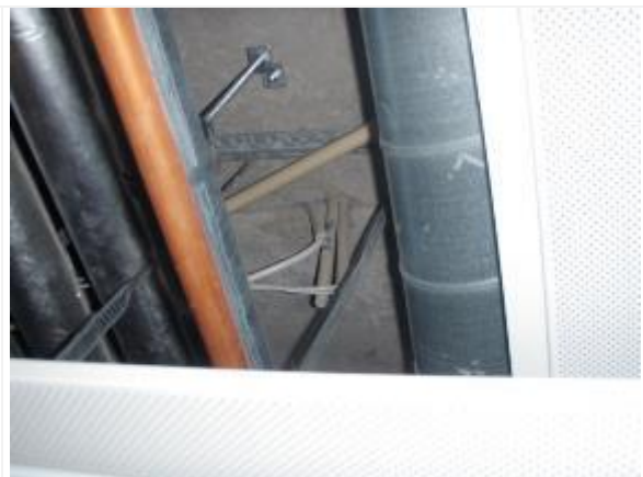
Kuva 74. Epätiivittä läpivienti yläpohjan ontelolaatastossa C-osalla.
