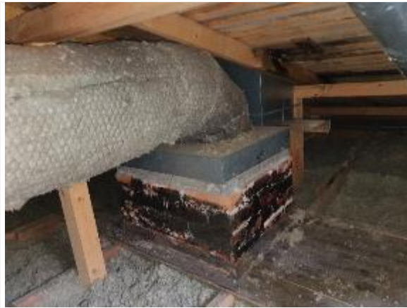
Kuva 99. Käytöstä poistettu IV:n tiilirakenteinen pystyhormi, huoneen A142 oven kohdalla, pois- ton runkokanavaa ei ole tulpattu.
