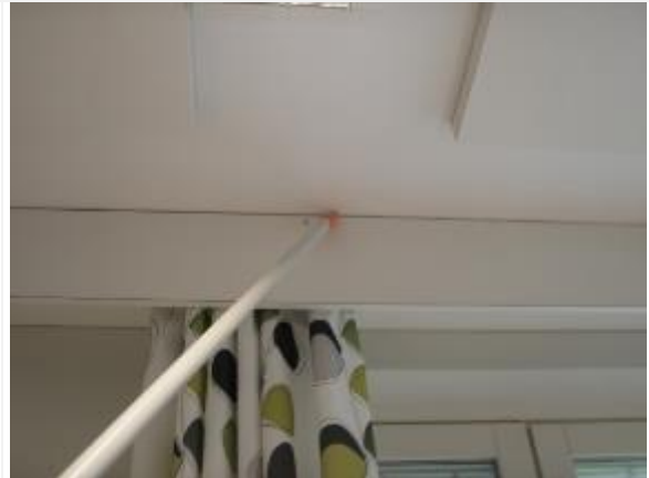
Kuva 78. Tyypillinen vuotokohta laskettaessa merkkiaine ulkoseinärakenteen eristetilaan, ulkoseinän ja yläpohjan liitos, B-osa 1krs.
