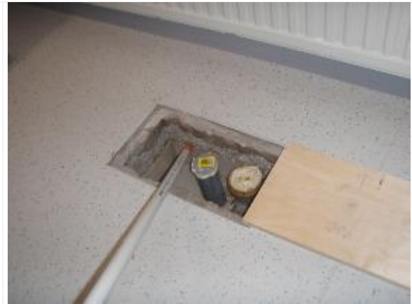
Kuva 89. Tekniikkakotelossa selkeä vuoto pohjalaatan kotelon reunojen kohdalla.
