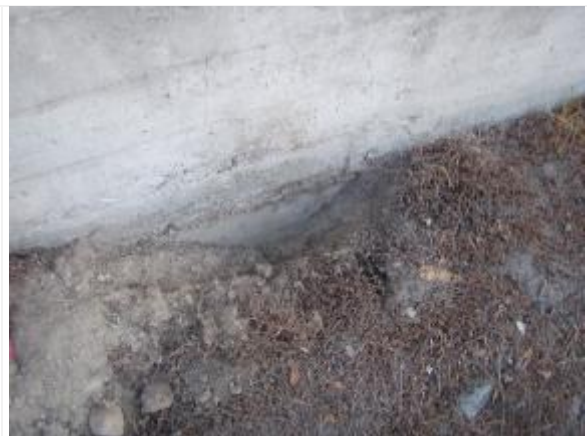
Kuva 17. B-osan sokkelissa ei ole kosteuseristystä.
